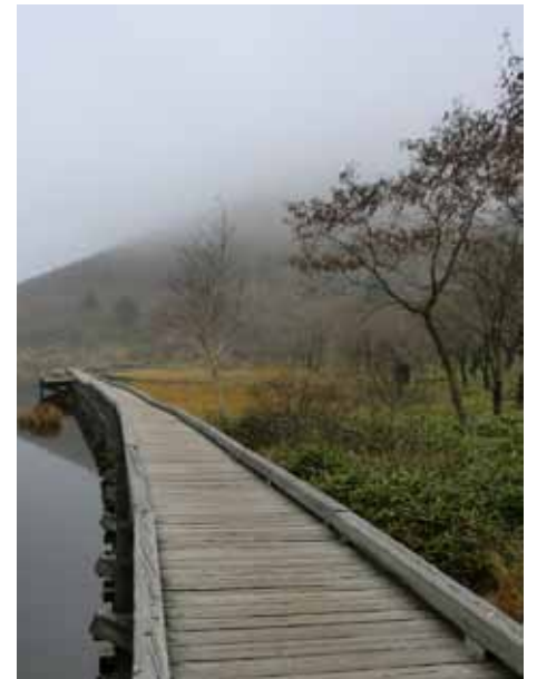
木道が水辺側に傾いているし、床板が飛び出して小さな段差になっている部分もあり、気を付けて走行しないと落ちてちる。
